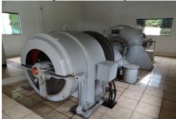
Figura 6 - Gerador de turbina
