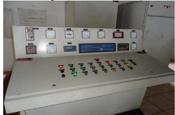
Figura 7 - Painel de comando
