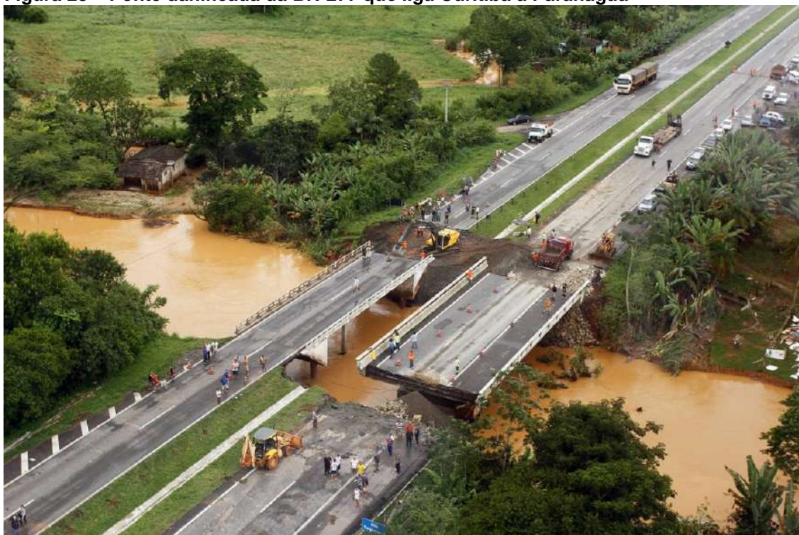
Figura 25 – Ponte danificada da BR-277 que liga Curitiba a Paranaguá
